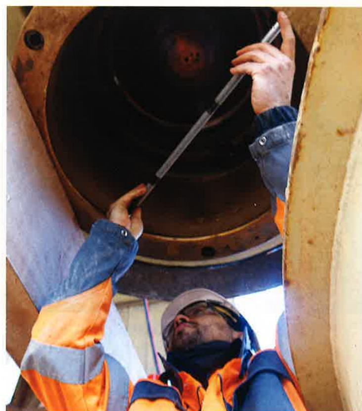
Prise de mesures par un technicien HMS lors d'une inspection effectuée sur un broyeur.
